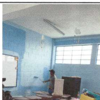
Foto 6: Pintura en paredes internas.
